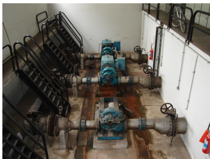
Fotografia 55: Casa de Bombas EAT São Braz
