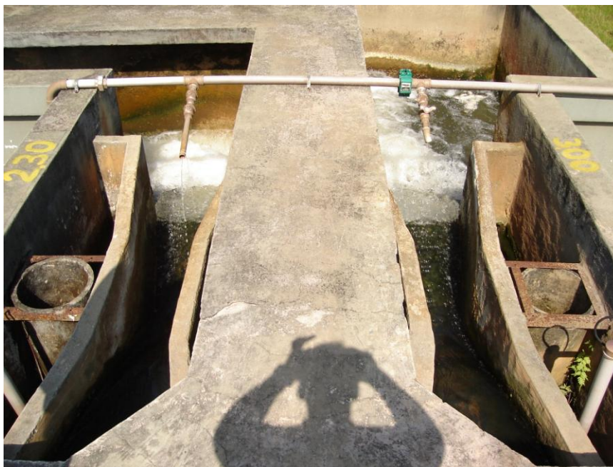
Fotografia 47: Aplicação de Sulfato de Alumínio no medidor Parshall – ETA 5º Setor
