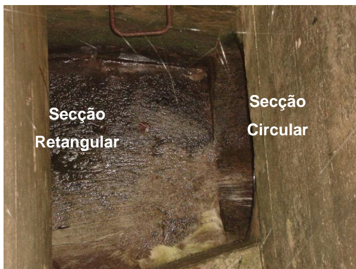
Fotografia 24: Caixa de mudança de secção da adutora de 800 mm
