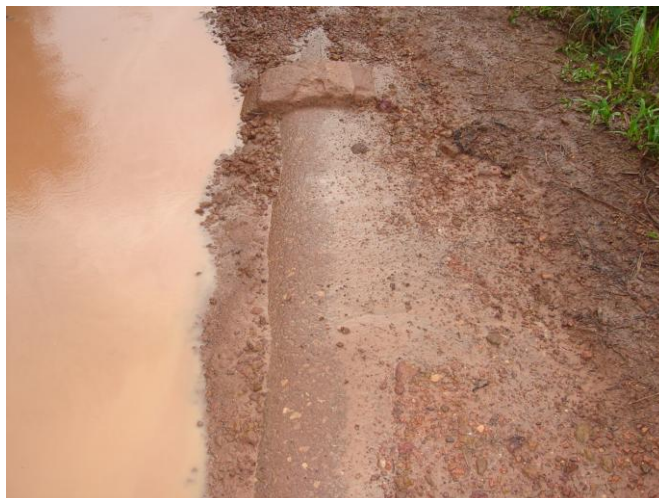
Fotografia 22: Adutora de água bruta do rio Guamá de 800 mm
