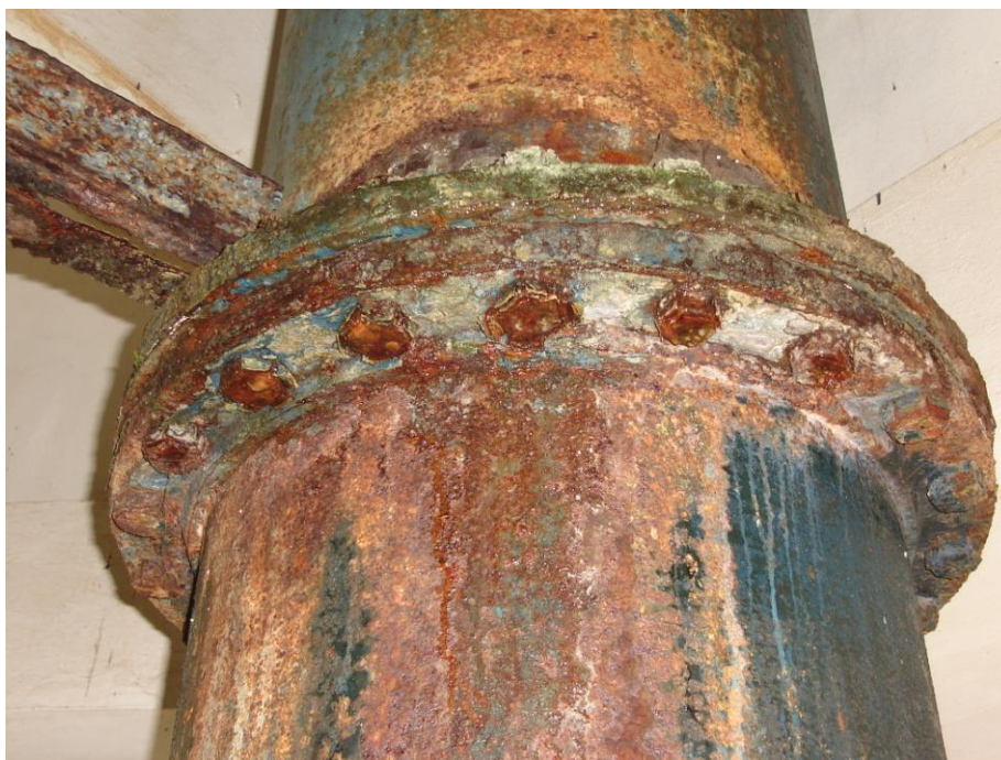
Fotografia 89: Tubulação de recalque de água tratada – 5º Setor
