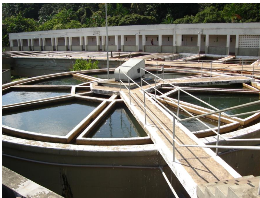
Fotografia 48: Floco-decantador tipo acelerador da ETA 5º Setor
