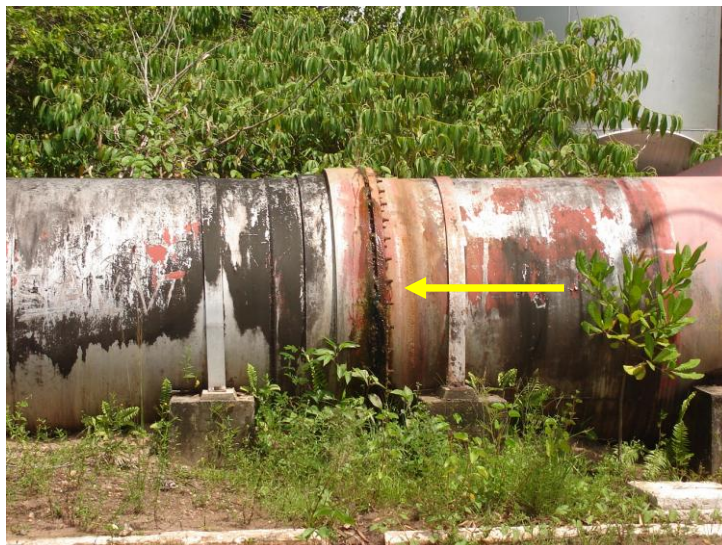
Fotografia 32: Vazamento na Adutora de Água Bruta Bolonha - ETA Bolonha
