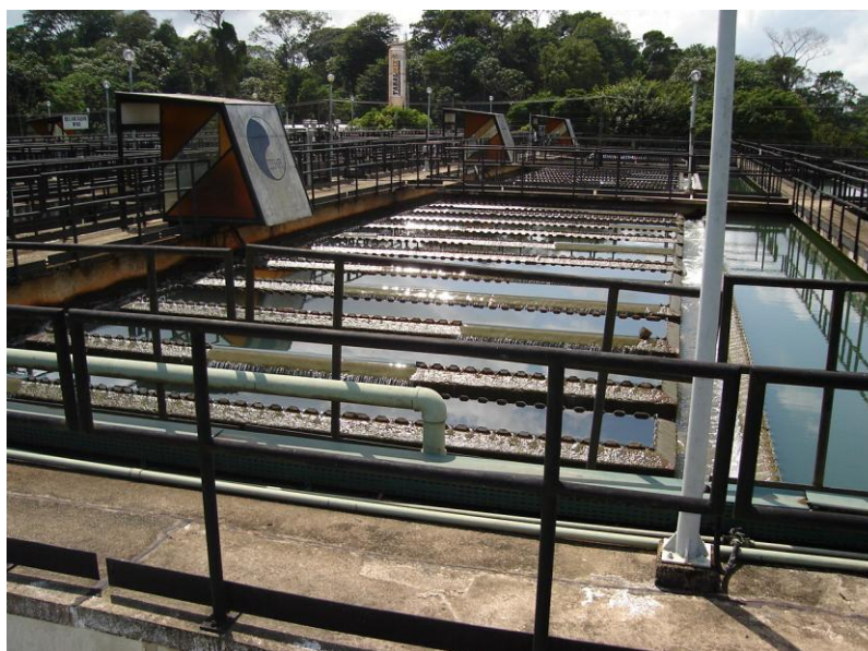
Fotografia 41: Decantadores ETA Bolonha
