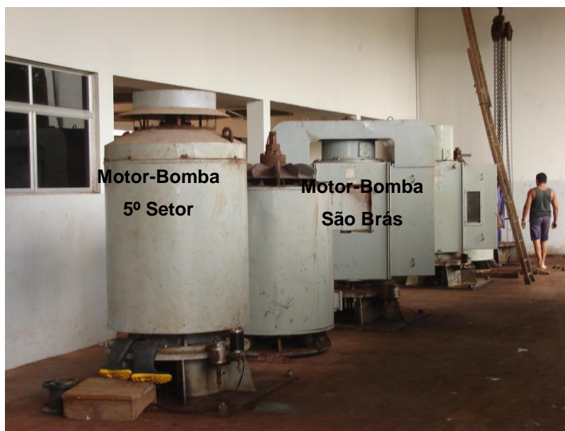
Fotografia 35: Conjuntos Motor-Bomba da EAB Utinga
