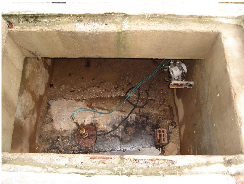
Fotografia 93: Tubo de Pitot interligando a adutora de água tratada da ETA Bolonha ao transmissor eletrônico para a leitura da vazão
