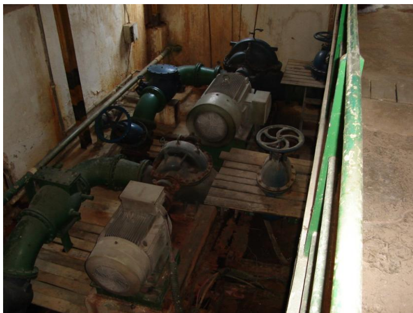
Fotografia 52: – Casa de Bombas da EAT 5º Setor
