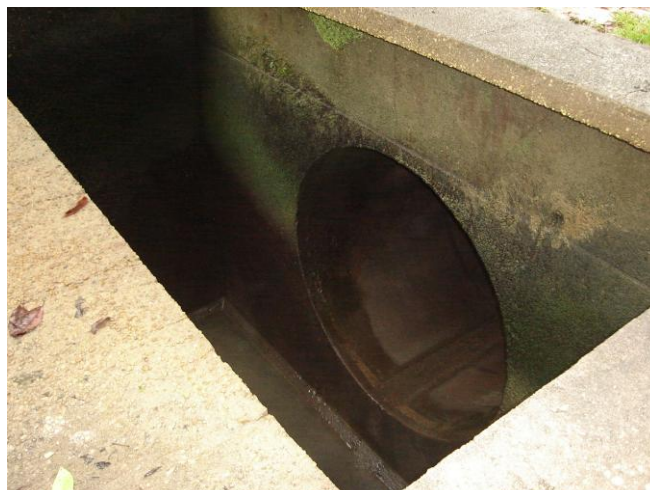
Fotografia 27: Chegada da adutora de 1.500mm no dissipador de energia
