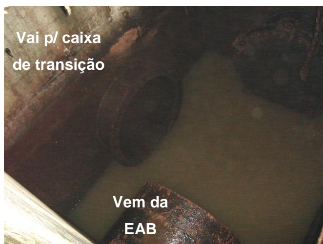
Fotografia 23: Caixa de desvio da adutora de 1.500 mm
