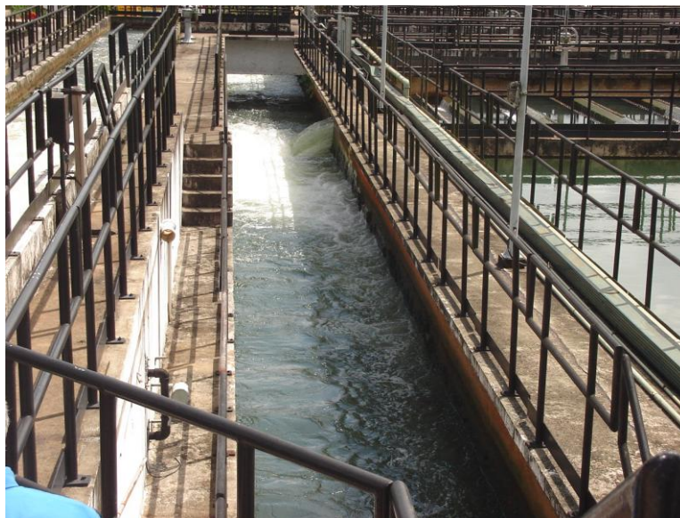
Fotografia 42: Saída dos efluentes dos decantadores ETA Bolonha
