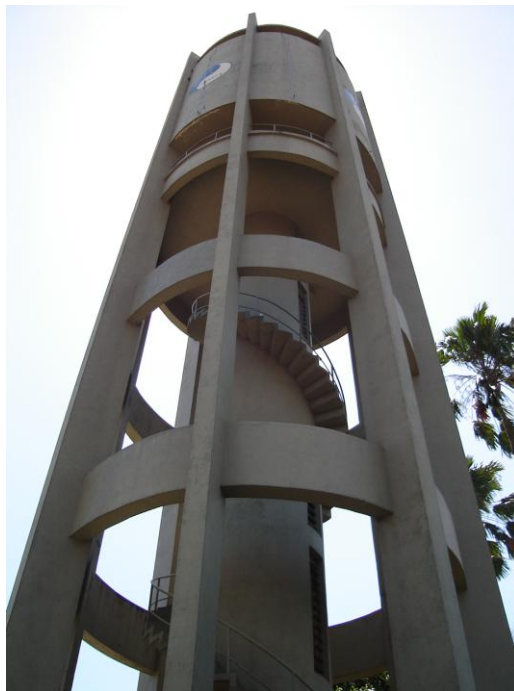
Fotografia 67: Reservatório apoiado de 4º Setor de abastecimento
