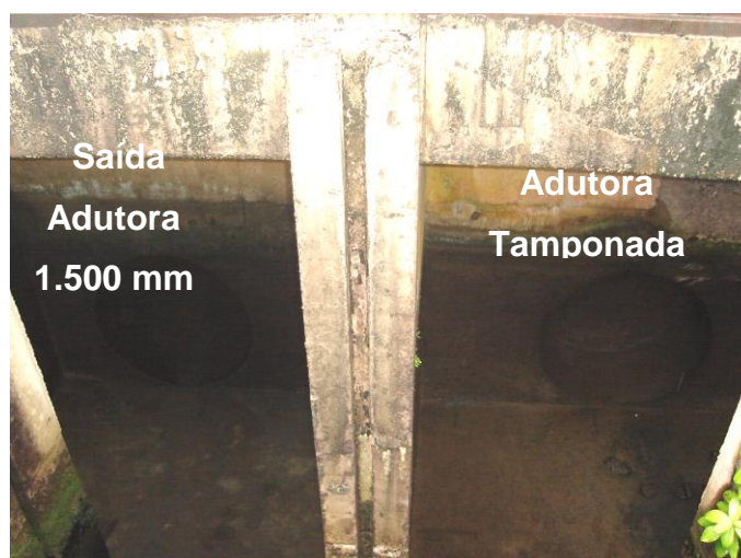
Fotografia 26: Saída da adutora de 1.500mm da caixa de transição
