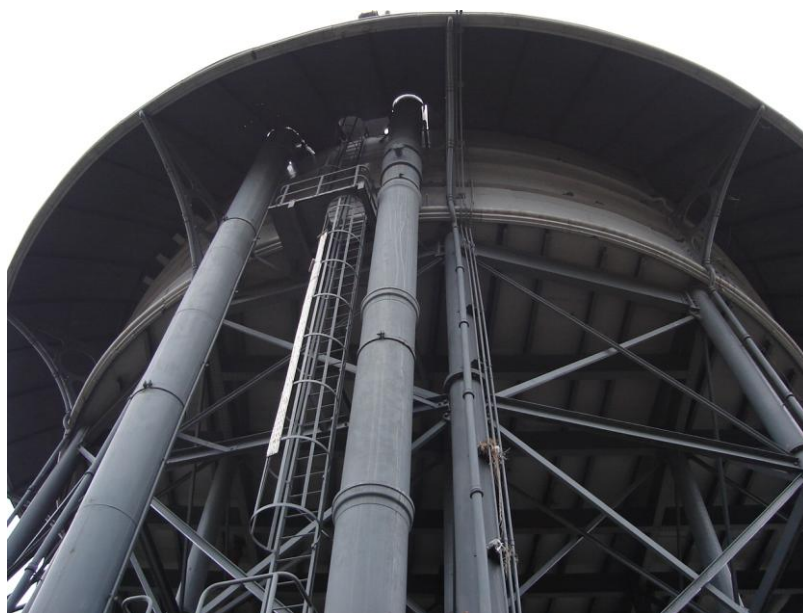
Fotografia 76: Reservatório apoiado do 6º Setor de abastecimento
