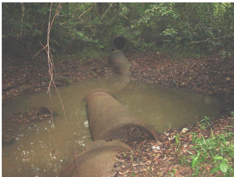
Fotografia 08: Primeira Adutora de água bruta do rio Guamá
