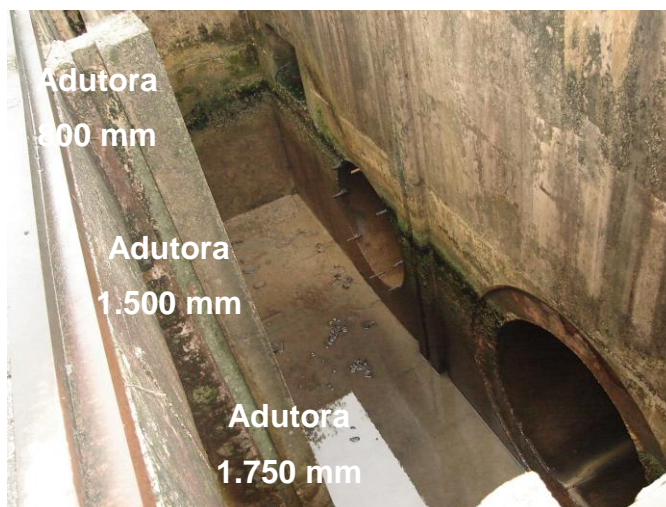
Fotografia 25: Chegada das adutoras do Guamá na Caixa de Transição
