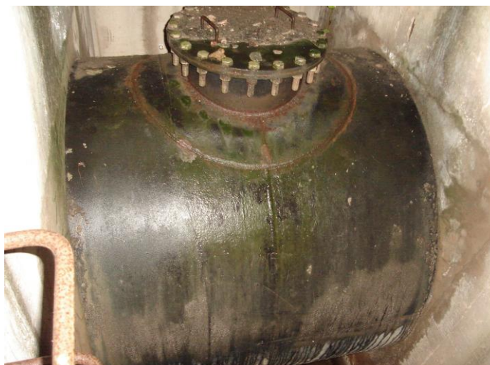
Fotografia 21: Adutora de água bruta do rio Guamá de 1.750 mm
