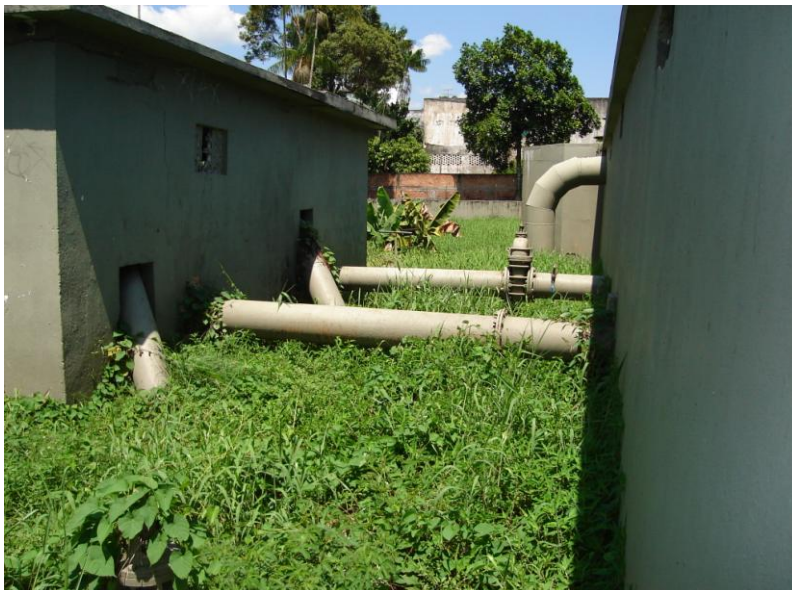
Fotografia 70: Casa de bombas – Poço 4º Setor (Desativado)
