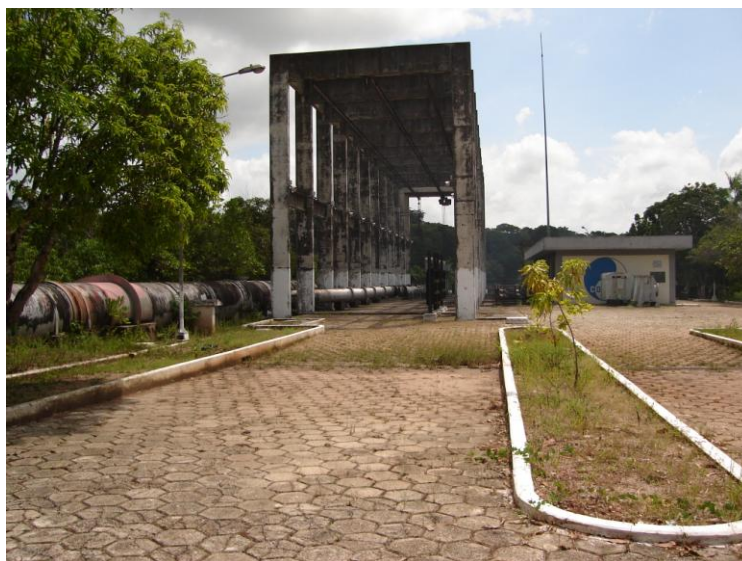
Fotografia 34: Estação Elevatória de Água Bruta (EAB) Bolonha
