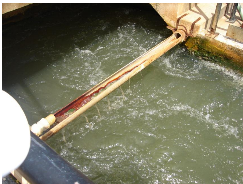
Fotografia 40: Adição de Sulfato de Alumínio na calha de Parshall – ETA Bolonha
