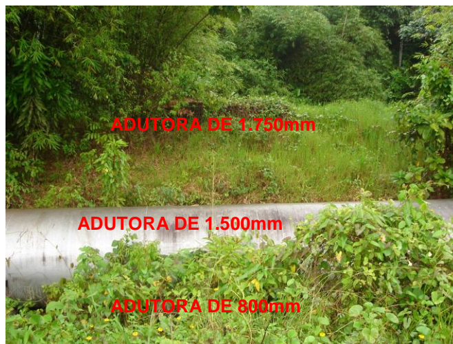
Fotografia 19: Posicionamento das adutoras de água bruta do rio Guamá
