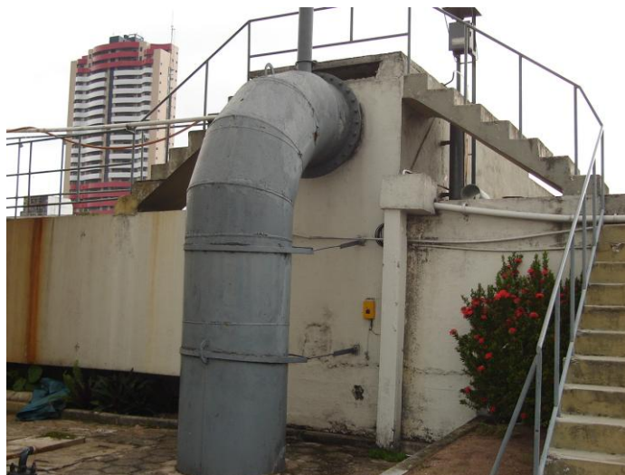
Fotografia 39: Chegada da Adutora de Água Bruta na ETA São Brás
