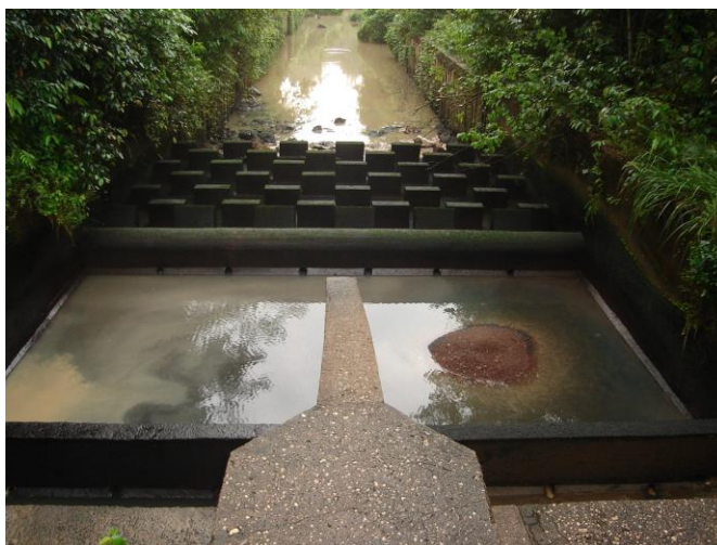
Fotografia 29: Dissipador de energia desaguando no lado Água Preta
