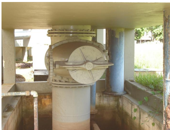
Fotografia 38: Chegada da Adutora de Água Bruta na ETA 5º Setor
