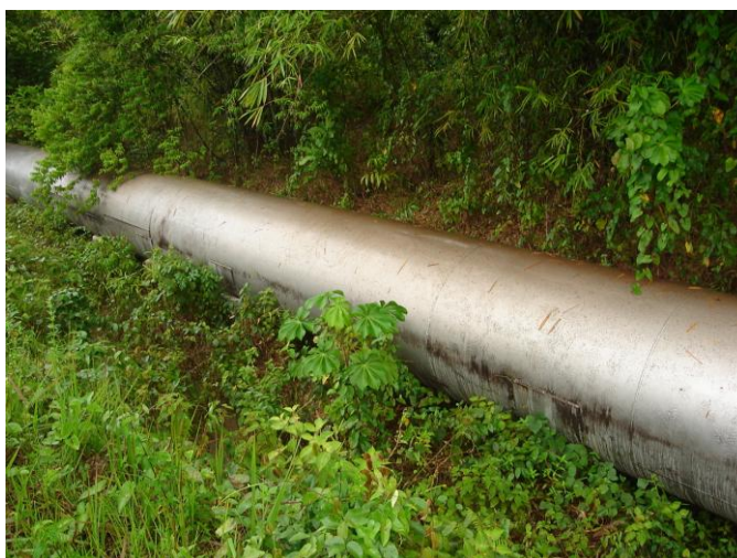
Fotografia 20: Adutora de água bruta do rio Guamá de 1.500 mm
