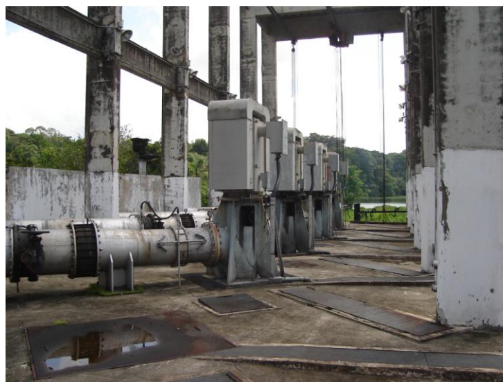
Fotografia 33: Conjuntos Motor-Bomba da Estação Elevatória de Água Bruta (EAB) Bolonha
