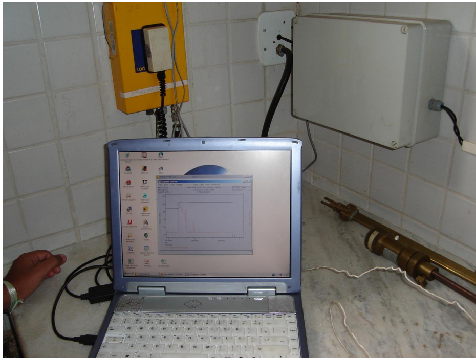
Fotografia 94: Interligação do LOGGER MATE ao computador para a descarga de dados instantâneos – ETA Bolonha
