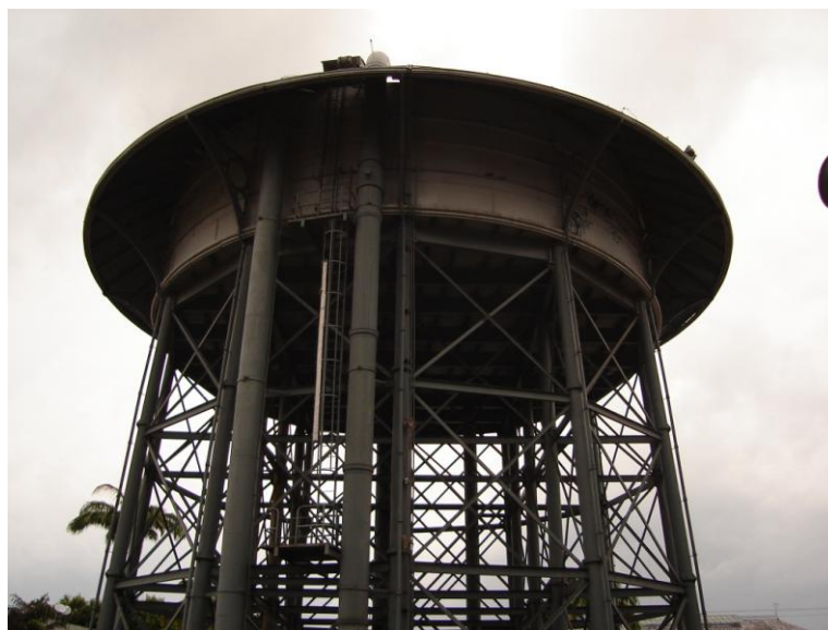
Fotografia 56: Reservatório Elevado ETA São Braz – 6º Setor
