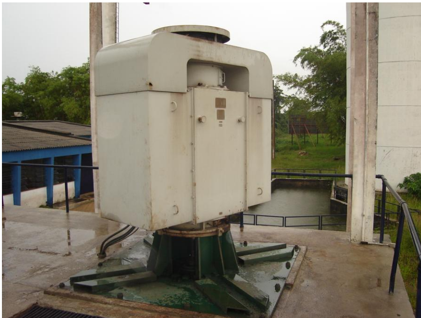
Fotografia 17: Conjunto motor-bomba de captação do rio Guamá
