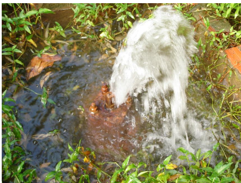
Fotografia 87: Vazamento em registro de gaveta – 13º Setor
