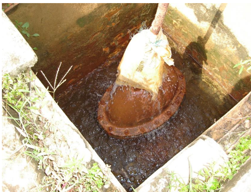
Fotografia 92: Rompimento de registro da adutora de água tratada do 5º Setor
