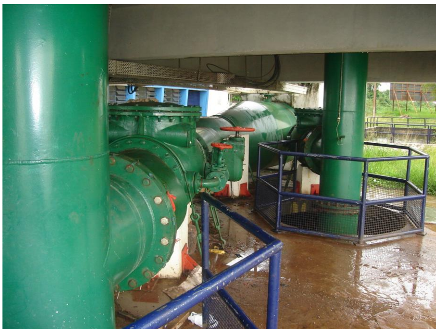
Fotografia 18: Tubulação de Recalque da EAB Guamá
